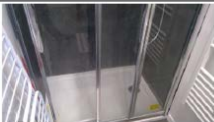
Salle d'eau / WC 1 : Pare douche Vitré
