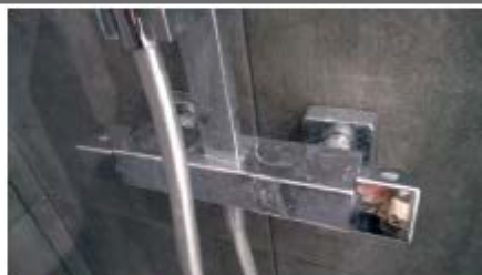
Salle d'eau / WC 2 : Douche : Robinetterie Mitigeur
