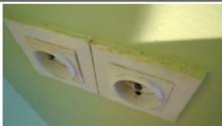
Cuisine : Prise électrique Simple
