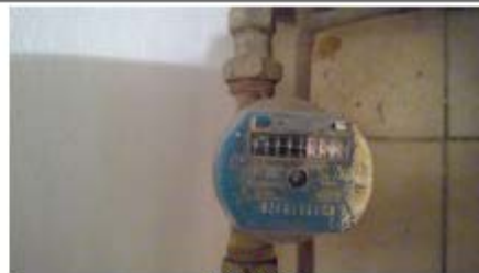
Compteur Eau & Chauffage : Eau froide
