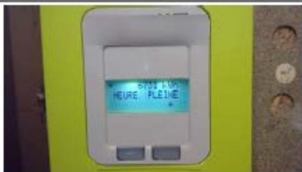
Compteur Électricité : Heures pleines
