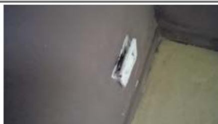
Chambre 2 : Prise électrique Simple
