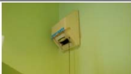
Cuisine : Ventilation VMC simple
