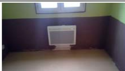
Chambre 2 : Chauffage Convecteur électrique
